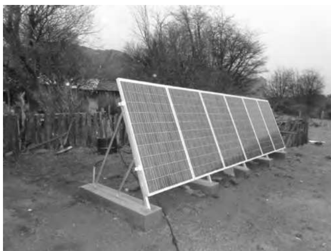
Figura 7. Fotografía de sistema de electrificación rural de 1,38 KW instalado en la comuna de Río Ibáñez.
